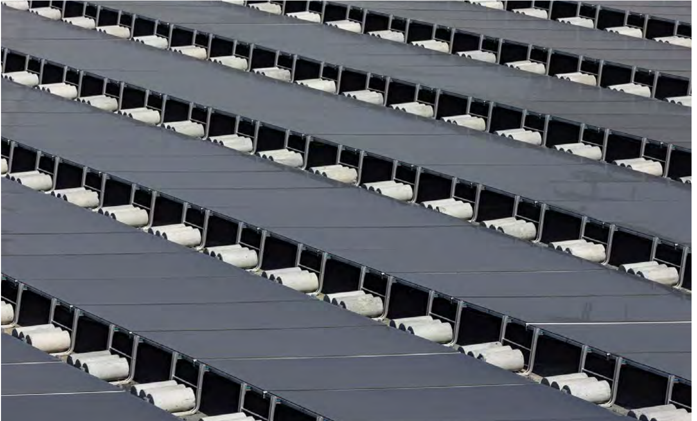
Proyecto de energía solar: 1,012 paneles para generar el 90% de la energía requerida para nuestro edificio corporativo en Monterrey, México.
